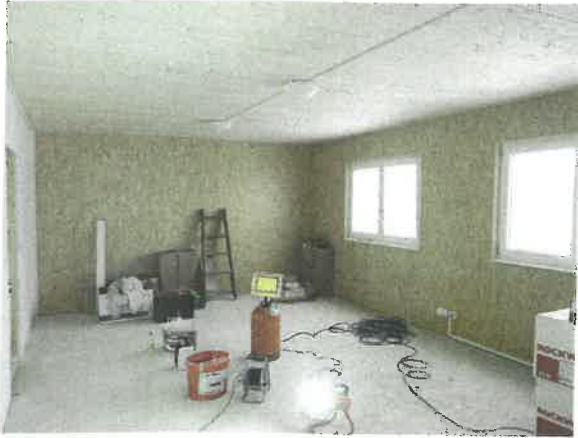
Die Decke besteht aus einer Brettsperrholzplatte, die Zwischenwände wurden mit Mineralwolle gedämmt
